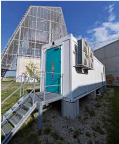
Der Batteriespeicher am Standort des Freihamer Geothermie-Heizwerks ist ein wichtiger Baustein des bestehenden sogenannten Virtuellen Kraftwerks der SWM.
